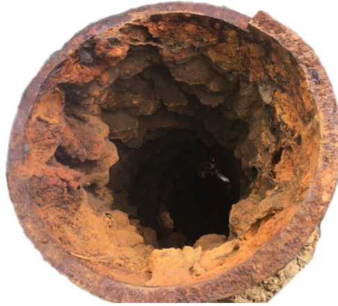
Figur 8. Gråjärnsrör från 1890 med invändig beläggning.
